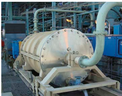
Мельница IsaMill M3000, установленная на предприятии компании Lonmin, Южная Африка
